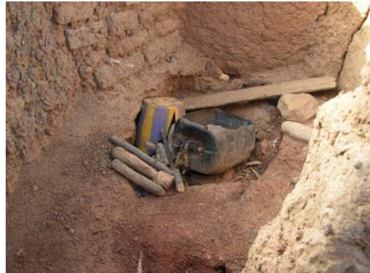
Photo 2 : Latrine traditionnelle effondrée (Nord)
