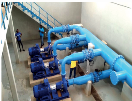
Electro-pompes à haut rendement de la station de pompage de Saaba
