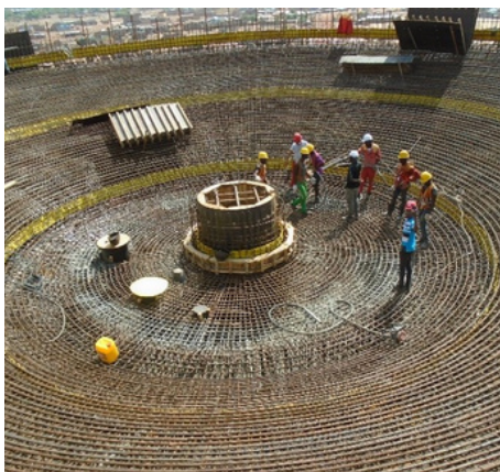
Cuve du chateau d'eau de 2000m3 de Yagma
