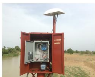
Plateforme de collectes données hydrométriques SUTRON à Télétransmission Satellites
