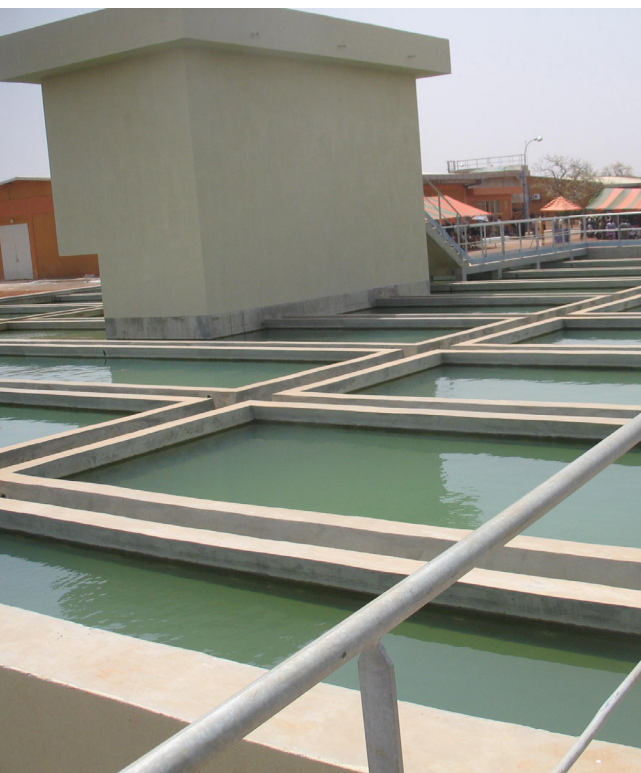
aperçu de la station de traitement de Ziga
