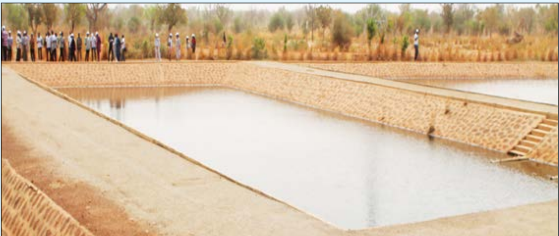
Une vue des eaux usées des bassins de traitement des boues de vidange de Zagtouli
