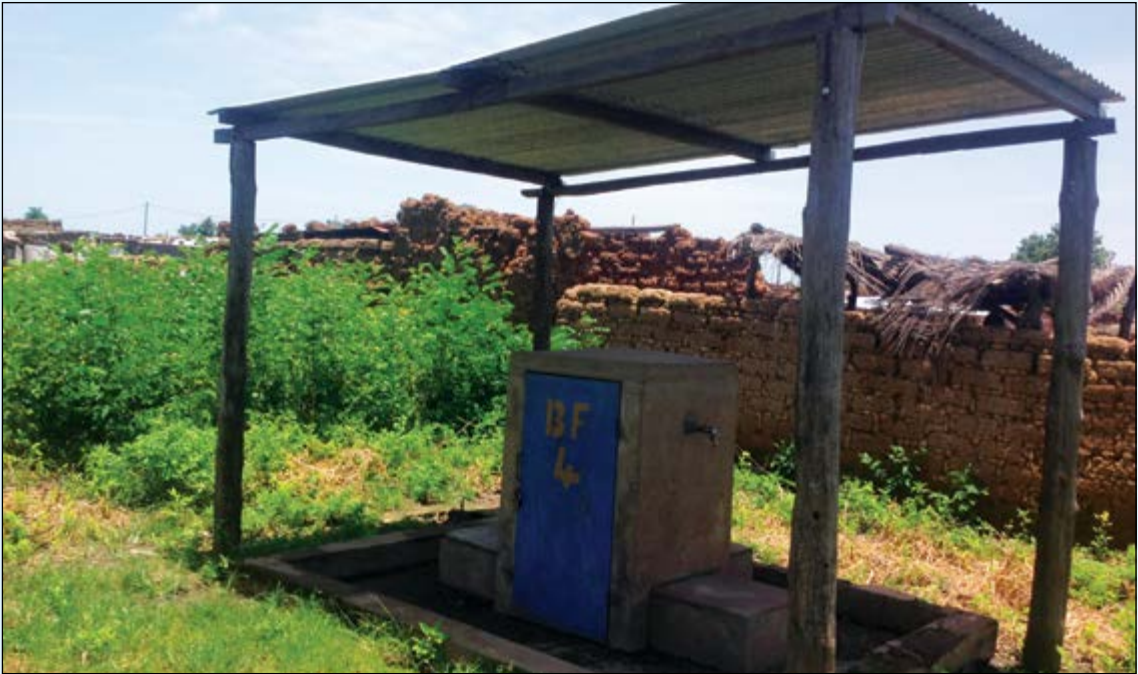
Borne fontaine réalisée par extension du réseau AEP grâce aux fonds transférés à la commune
