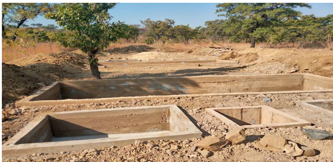
Photo 23 : Modèle d'ouvrage étanche de traitement de l'or au cyanure
